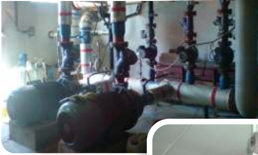
Zdjęcie 3. Urządzenia w pompowni PAN przed realizacją projektu
